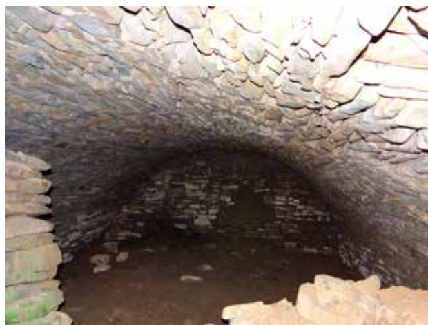
Fot. 2. Tworylne, piwnica 3, 14.02.2015; fot. Konrad Sachanowicz
